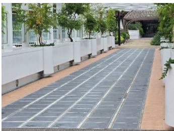
本館・南館7階連絡橋（路面ソーラー400）
