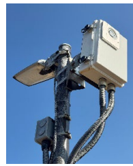
遠隔監視システム
