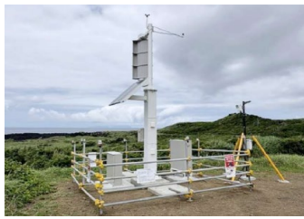
小型風力発電機全体
